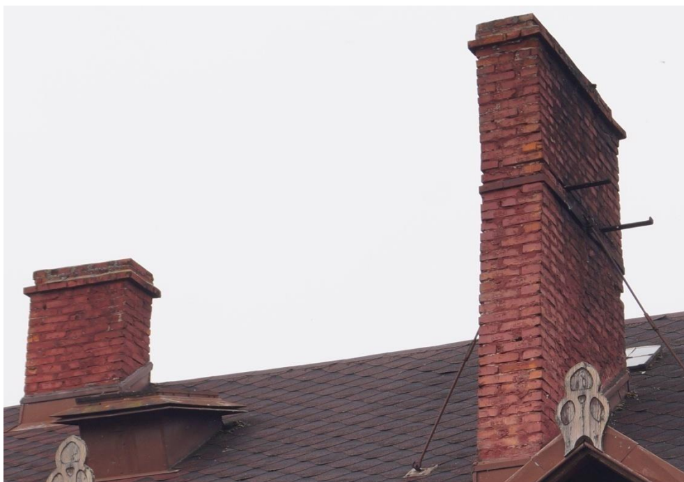
Fot. 49 (wyk. mgr W. Tomaszewski): Widok stanu zachowania kominów wzniesionych czerwonej cegły.
