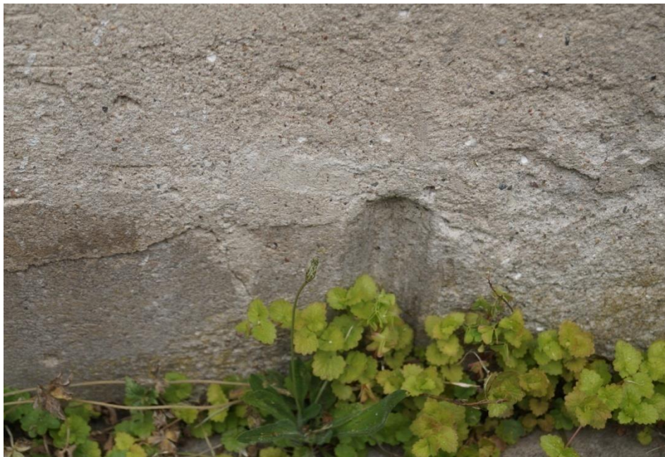
Fot. 95 (wyk. W. Tomaszewski): Fragment zachowanego oryginalnego boniowania zatarty współczesną zaprawą o podobnych parametrach.
