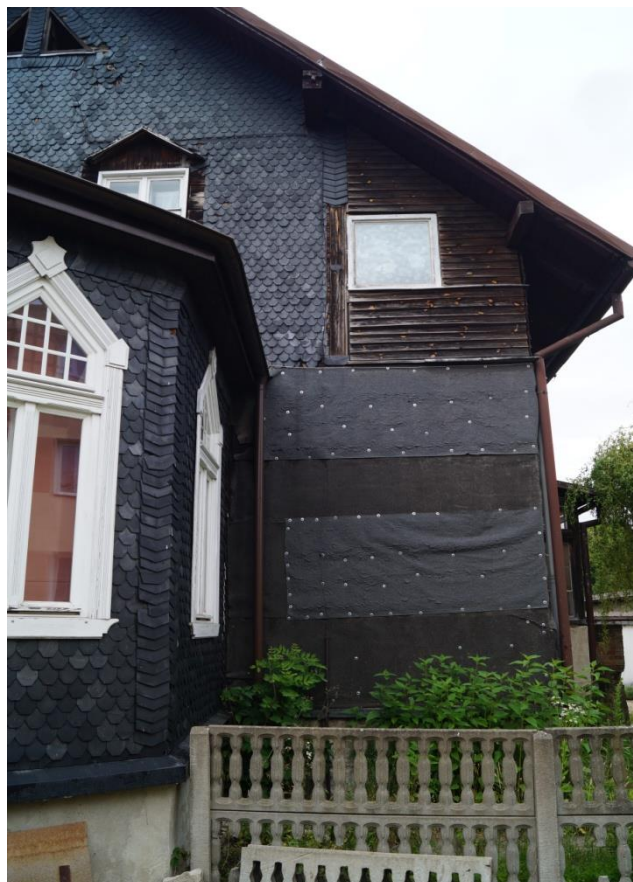
Fot. 13 (wyk. W. Tomaszewski) Widok fragmentu elewacji południowej, gdzie widoczne są bardzo duże ubytki w okładzinie z łupka węglowego, które obecnie zakryte są papą dekarorską.
