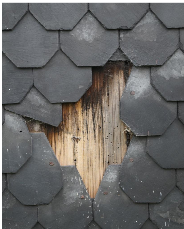
Fot. 37 (wyk. W Tomaszewski): Wybrany fragment elewacji z odsłoniętym deskowaniem, na którym zamocowany jest tupek węglowy.
