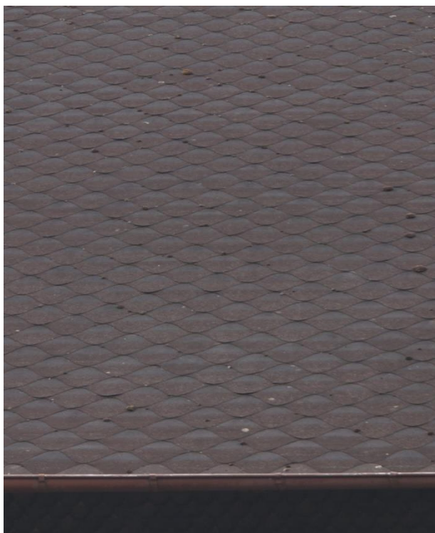
Fot. 43 (wyk. mgr W. Tomaszewski): Wtórne pokrycie dachu współczesnym gontem bitumicznym.
