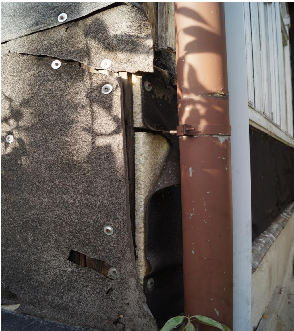
Fot. 92 (wyk. W. Tomaszewski): Użycie styropianu bezpośrednio na deskowaniu i pokrycie go papą tworzy szczelną okładzinę. Są to materiały nieoddychające, pod ich powierzchnią swobodnie mogą rozwijać się grzyby, pleśń oraz inne mikroorganizmy na drewnie.
