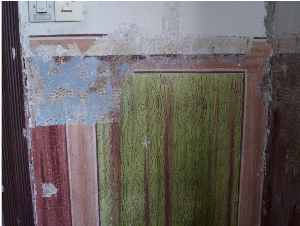
Fot. 111 i 112 (wyk. W. Tomaszewski): Odkrywka stratygraficzna ukazująca, że pod wtórną warstwą malarską (imitacja wielobarwnej okładziny drewnianej) znajduje się kolejna wtórna warstwa malarska w kolorze jasno-niebieskim . Dopiero pod tą warstwą znajduje się oryginalna lamperia z dekoracyjnym motywem ornamentycznym.
