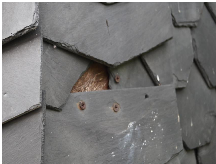
Fot. 89 (wyk. W. Tomaszewski): Współczesne mocowanie oderwanych fragmentów elewacji stalowymi wkrętami do płyty OSB. Użycie stalowych wkrętów na zewnątrz powoduje ich korozję co powoduje rdzawe przebarwienia na łupku węglowym.
