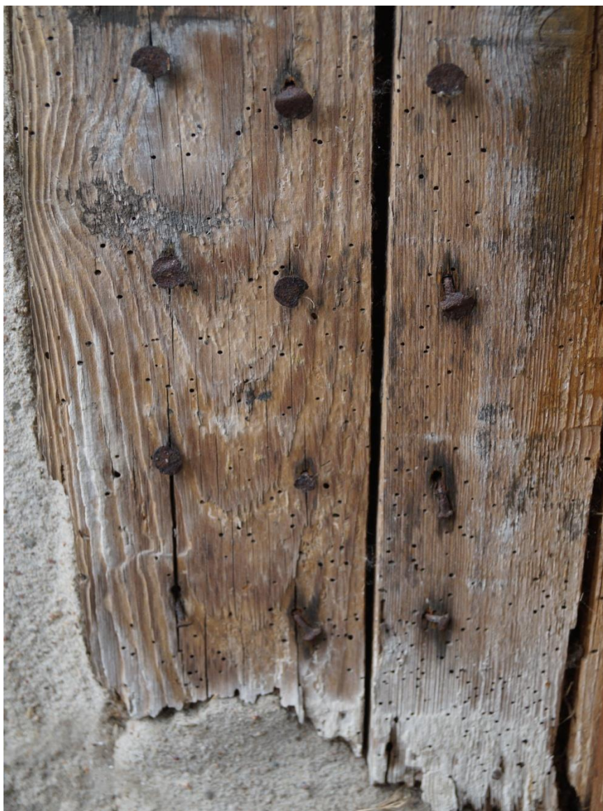
Fot. 93 (wyk. W. Tomaszewski): Odślonięty fragment szkieletu konstrukcji. Widoczne wloty owadów bytujących w drewnie. Ich obecność bardzo mocno osłabia strukturę drewna.
