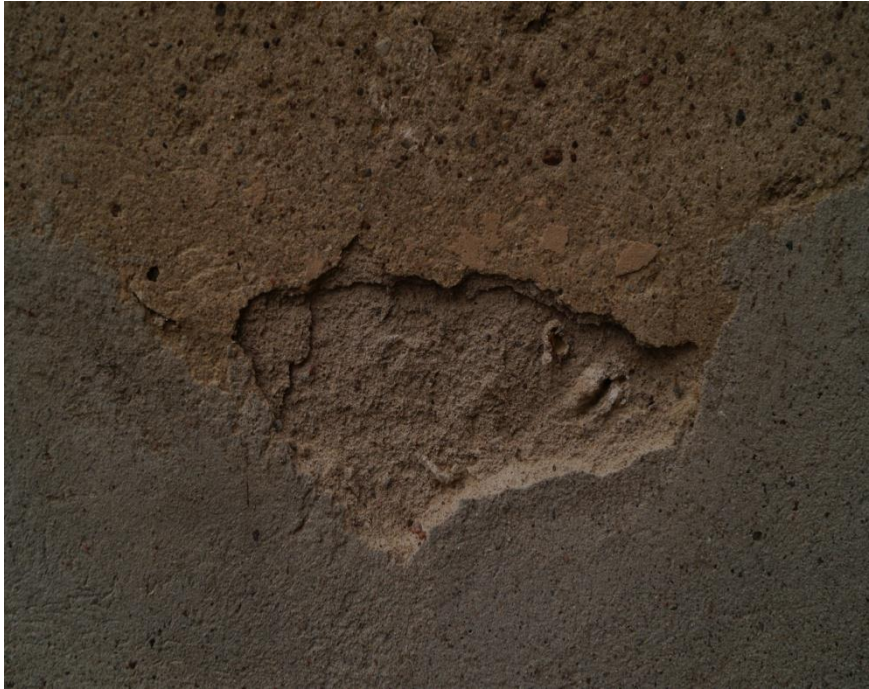
Fot. 94 (wyk. W. Tomaszewski): Nieliczne małe ubytki na powierzchni tynków na elewacji klatki schodowej .
