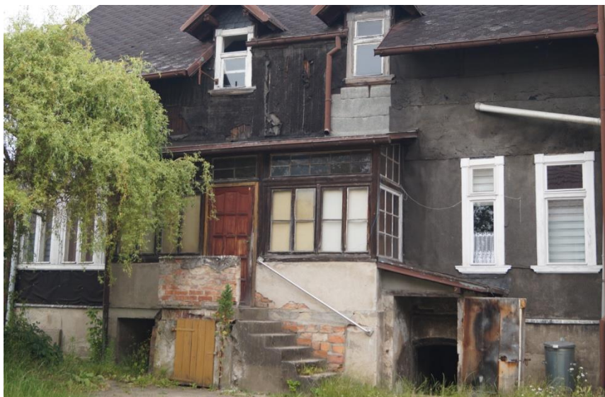
Fot. 17 (wyk. W. Tomaszewski): Zbliżenie na fragment elewacji od strony wschodniej. Widoczna weranda, wejście do piwnicy i ściana elewacji, gdzie widoczne są bardzo duże ubytki w okładzinie z łupka węglowego. Deskowanie obecnie zakryte jest papą dekarstką.
