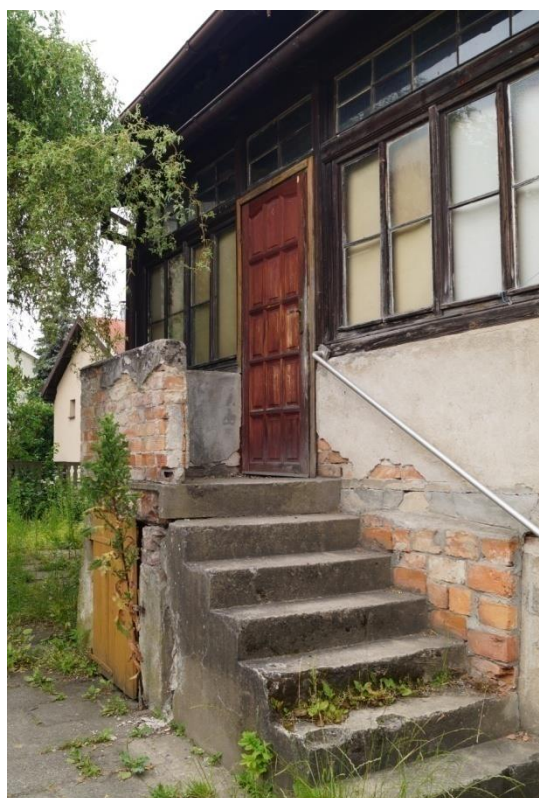
Fot. 18 (wyk. W. Tomaszewski): Schody prowadzące do drewnianej werandy od strony wschodniej. Widoczne są ślady amatorskich, doraźnych napraw w postaci cementowych szlicht i szpachlowań oraz przemurowań. W otwór wejściowy obsadzono wtórną/współczesną stolarzkę drzwiową.
