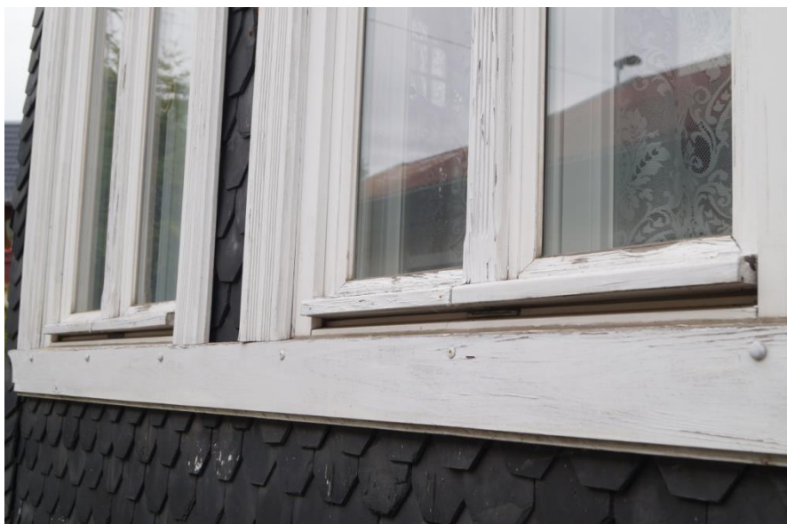
Fot. 66 (wyk. W. Tomaszewski): Współczesna stolarka okienna wzorowana na pierwotnej. Okapniki okien o współczesnej formie.
