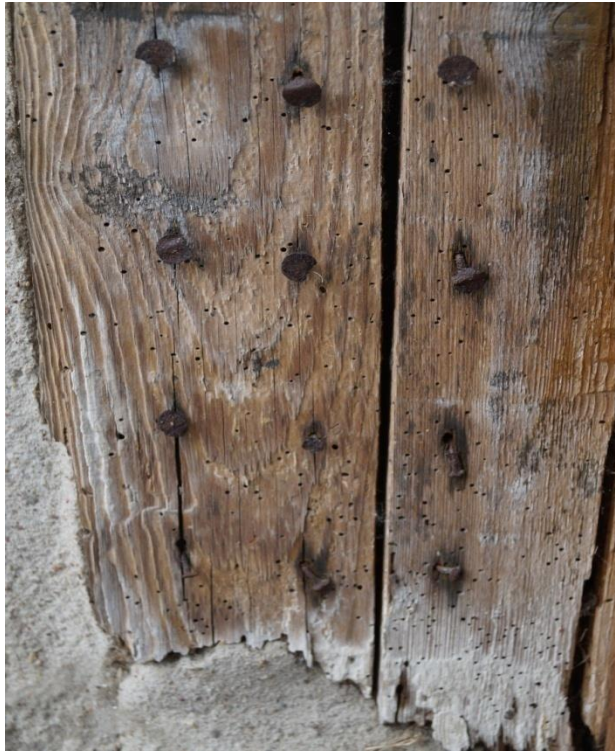
Fot. 32 (wyk.: W. Tomaszewski): Drewniana belka konstrukcyjna z nabitymi gwoździami mocującymi łupek węglowy.
