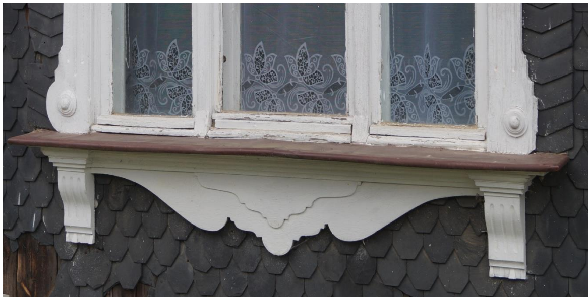
Fot. 52 (wyk. W. Tomaszewski): Fragment dolnej opaski okiennej w postaci ozdobnej płyciny, parapet pokryty oryginalną blachą cynkową wsparty na klasycyzujących wspornikach.
