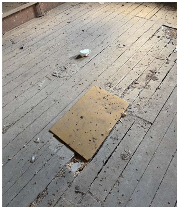
Uszkodzona podłoga na strychu
