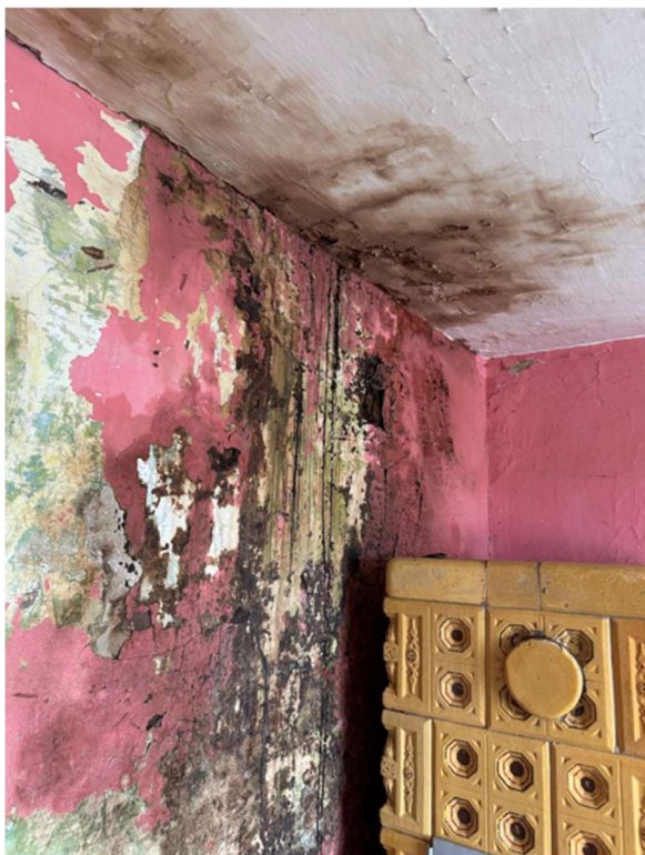
Wykwity smolne na ścianie w lokalu nr 3
