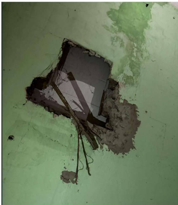
Brak okna na klatce schodowej
