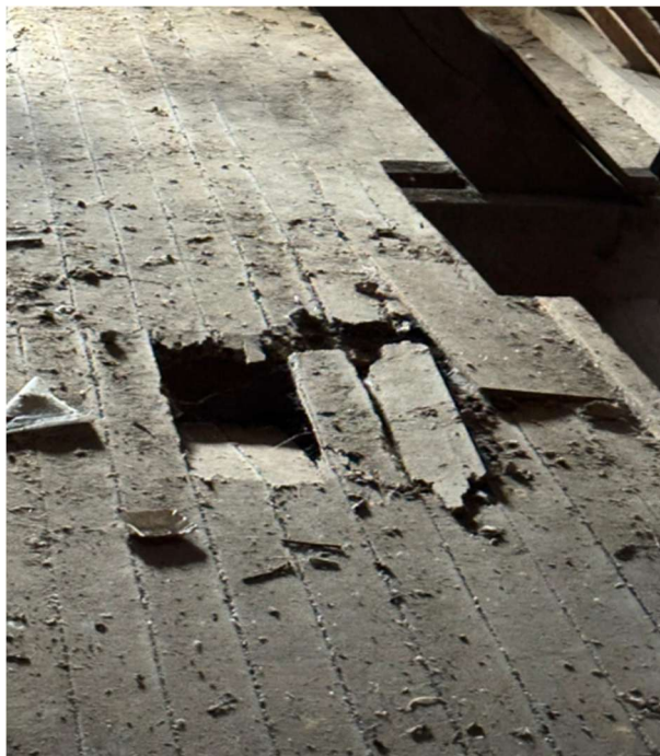
Uszkodzona podłoga na strychu
