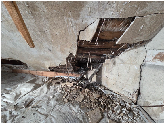
Fot. 13 Zniszczenie deskowania dachu w okolicach kosza od strony północnej (ul. Koszalińska).
