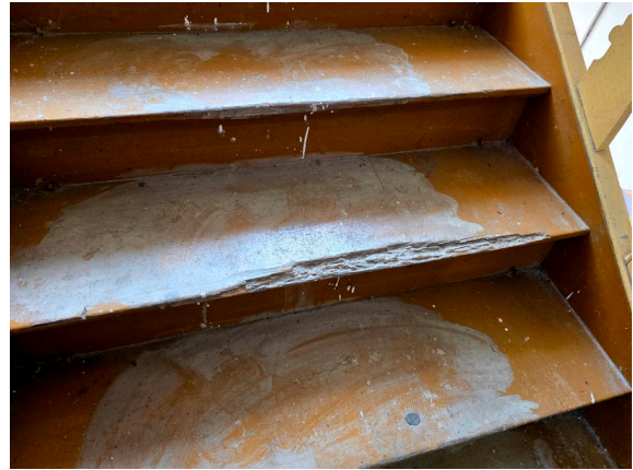
Fot. 24 Elementy drewnianych stopnic i podstopnic należy wymienić.
