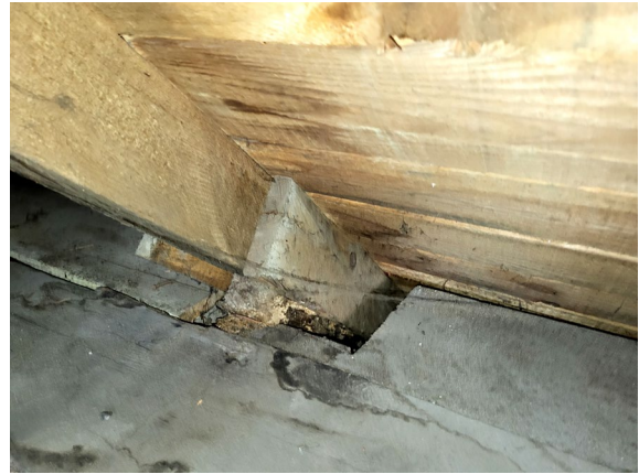
Fot. 12 Widok wzmocnień (nadbitek krokwi), wykonanych prawdopodobnie podczas remontu w 2001r.
