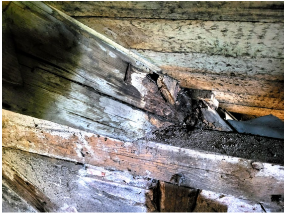
Fot. 7 Fragment krokwi koszowej (oparcie na ścianie kolankowej). Widoczna skala zniszczenia materiału.
