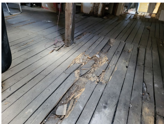
Fot. 1 Pozostałości drewnianej podłogi pomieszczenia stryhowego.
