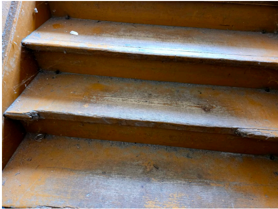
Fot. 23 Stopnie klatki schodowej. Widoczne zużycie materiału.
