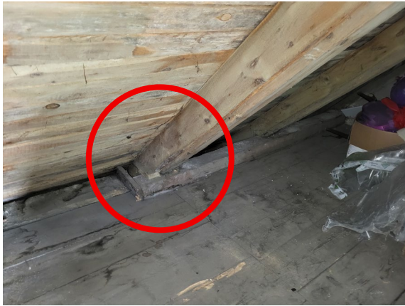
Fot. 11 Długotrwałe zawilgocenie elementów konstrukcji więźby dachowej i jego skutki.
