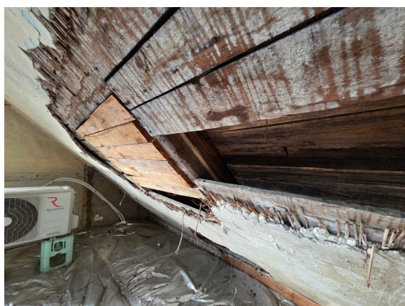
Fot. 22 C.d. zniszczeń spowodowanych przeciekami pokrycia dachowego.
