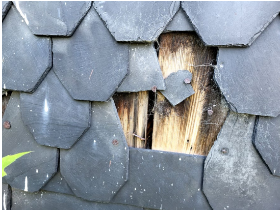
Fot. 25 Fragment uszkodzonego licowania elewacji.
