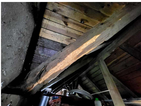
Fot. 9 Degradacja drewna elementu krokwi koszowej klatki schodowej na styku z połacią dachu głównego.
