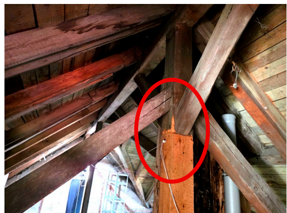
Fot. 16 Sztukowanie słupa nośnego (wykonane prawdopodobnie w czasie remontu w 2001r)
