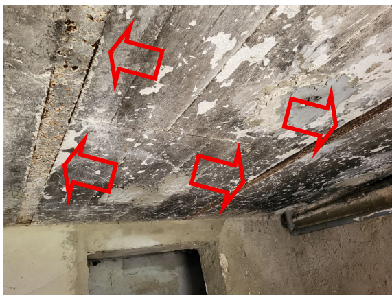
Fot. 27 Stopki belek stalowych (IPN200) należy wypiaszkować i zabezpieczyć powłoką antykorozyjną.
