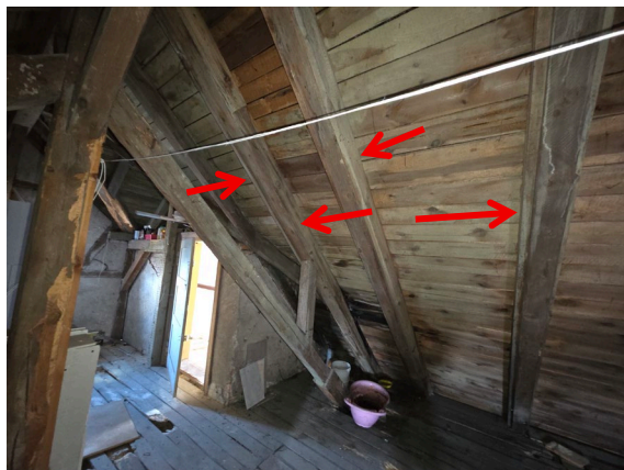
Fot. 18 Nadbitki wykonane prawdopodobnie w celu likwidacji nadmiernych ugięć elementów krokwiowych.
