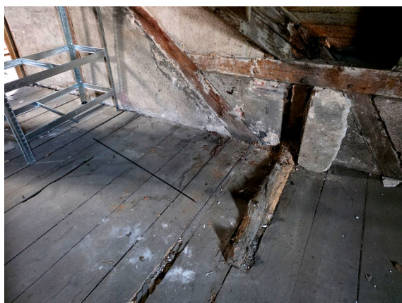
Fot. 20 Zniszczenia w narożniku północno-zachodnim.
